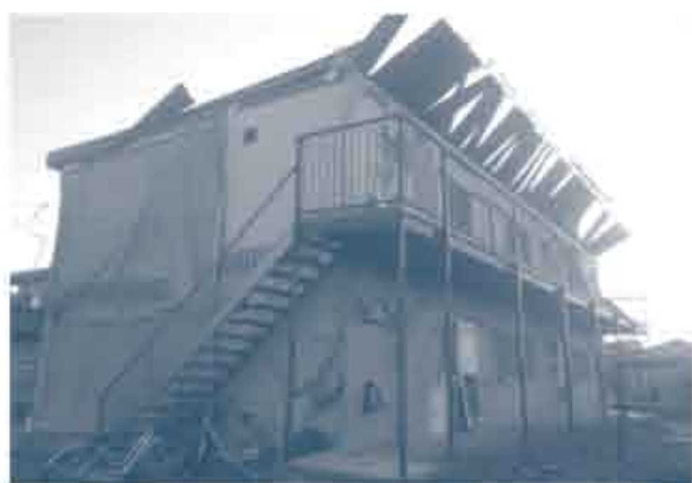
屋根材がはがれたアパート
