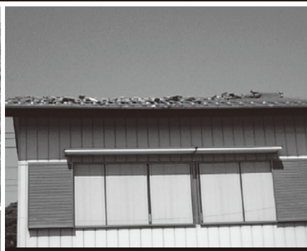
市内でも屋根瓦崩落等の被害
